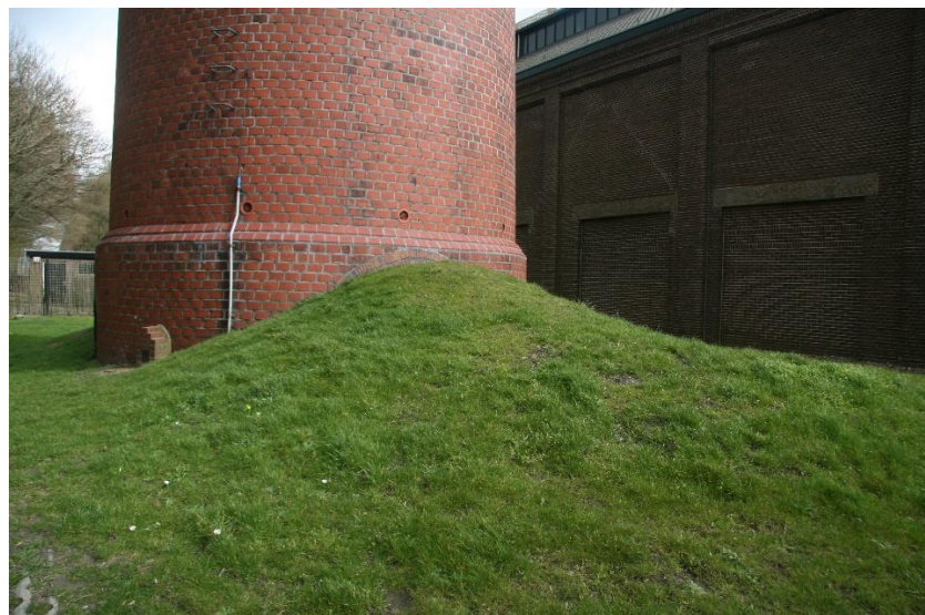
Begraven rookgaskanalen (op de schoorsteen de bliksemafleider)
